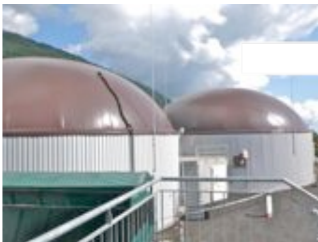
Biogaz de Lignerolle VD
